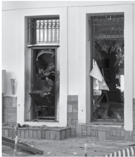
Η κατεστραμμένη θέση του ΑΤΜ και η είσοδος του ταχυδρομείου
